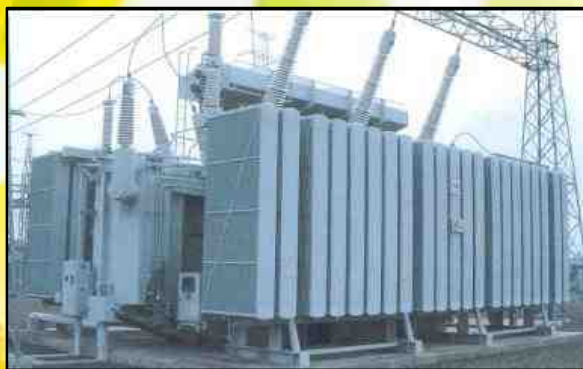
系統用変圧器 (一次変電所)
