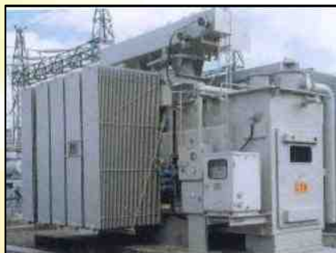
配電用変圧器 (変電所)
