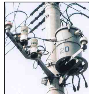
柱上変圧器 (住宅街にある電柱)
